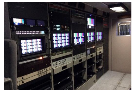
内部 VEラック
